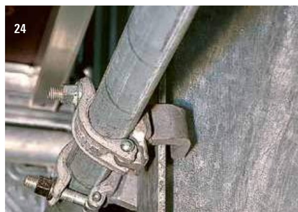
24 Balkkopplingar monterade mot stål balk.
